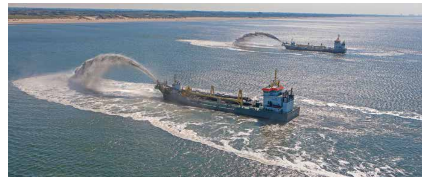
Самоотвозные трюмные земснаряды компании Boskalis выполняют намыв грунта у побережья Бахрейна с использованием цифрового планирования циклов загрузки и выгрузки
