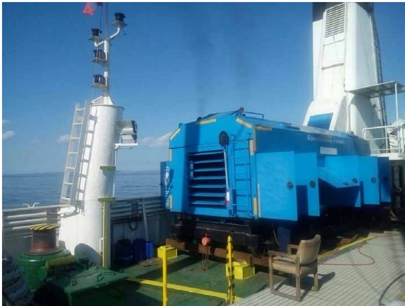
Компрессорная станция ТГА на судне
